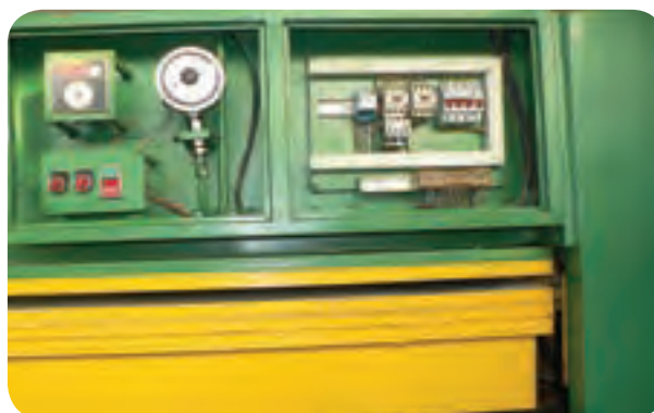
شکل ۸۴-۵: تابلوی فرعی برق نصب شده روی پرس
