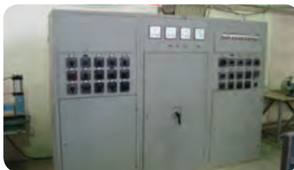
شکل ۸۳-۵: تابلوی اصلی سه فاز برق کارگاه
