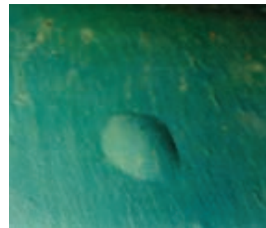
شکل ۸-۴۴- تاول زدگی سطح کار بعد از رنگ.
