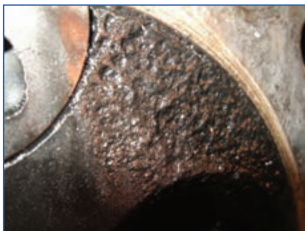
شکل ۲۷-۴- حفره‌های ایجاد شده بر اثر زنگ‌زدگی
