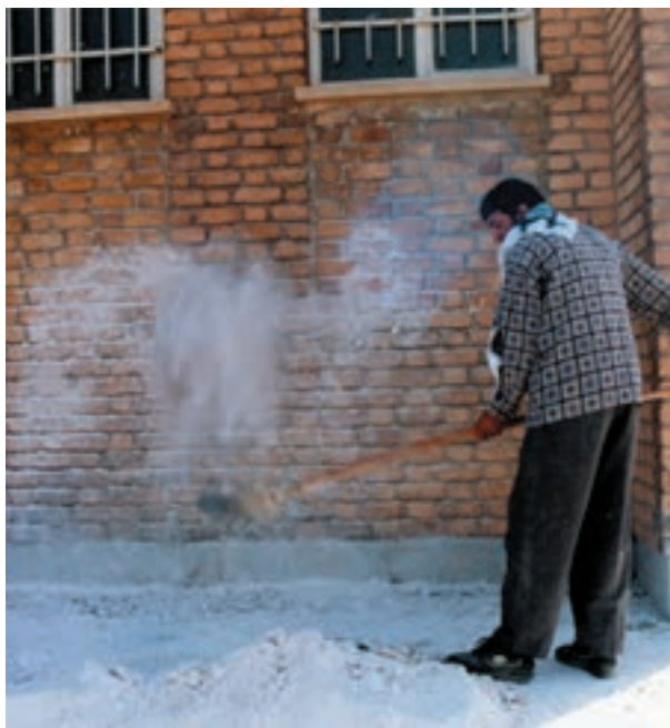
گردپاشی خارج از جایگاه
