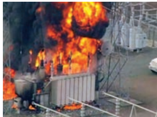
شکل ۲۰- انفجار ترانسفورماتور قدرت
