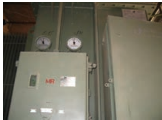
شکل ۲۴- محل نصب ترمومتر سیم پیچ و روغن روی یک نمونه ترانسفورماتور
