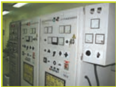
شکل ۱۲- تابلوی فرمان سه ژنراتور که با شبکه برق سراسری موازی شده اند
