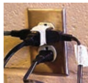
شکل ۲-۱۷ انشعاب غیر استاندارد از پریز برق.
