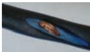
شکل ۲-۱۶ کابلی که روکش عایق آن با شیئی برنده بریده شده است.
