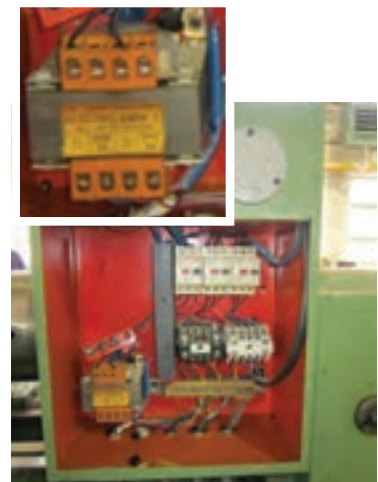
شکل ۴-۱۳ ترانسفورماتور در تابلوی برق دستگاه تراش.
