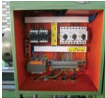
(ب) نمونه کاربردی در تابلوی برق دستگاه تراش
