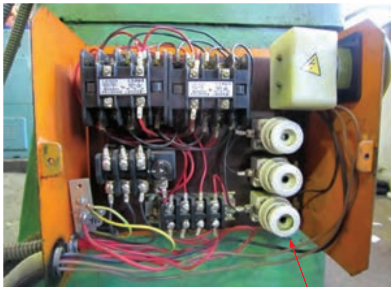
(الف) تابلو برق ماشین تراش
