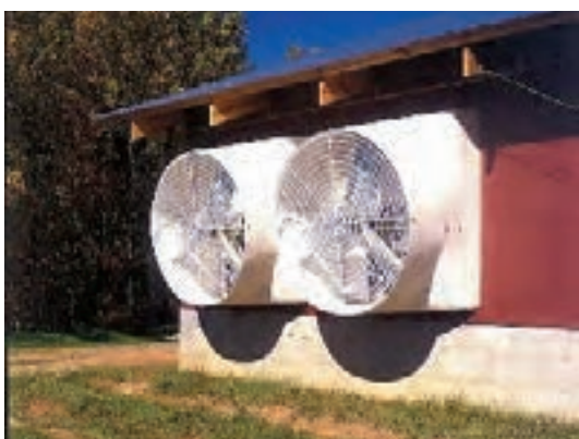
شکل ۱۸-۳- هواکش روی دیوارهای جانبی سالن پرورش طیور
