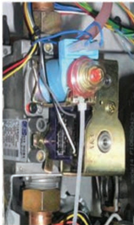
شکل ۱۴-۱۵- شیر کنترلر گاز
