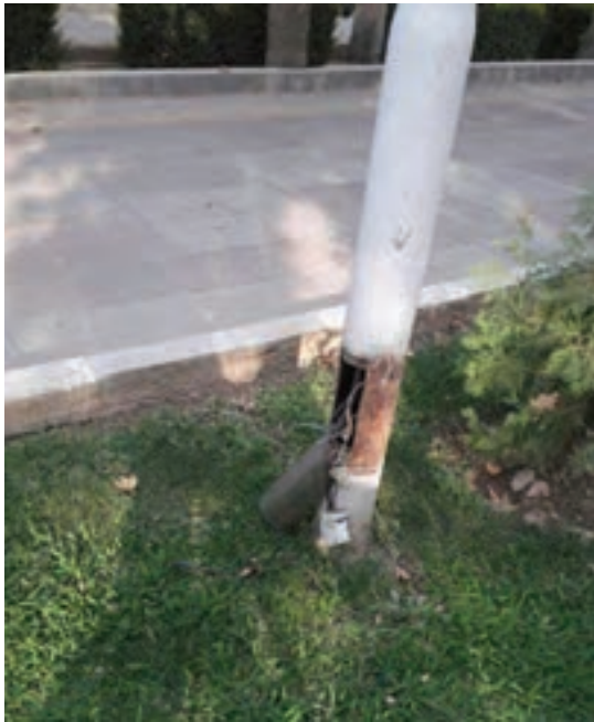
شکل ۲- وجود خرابی در سیستم برق کشی
