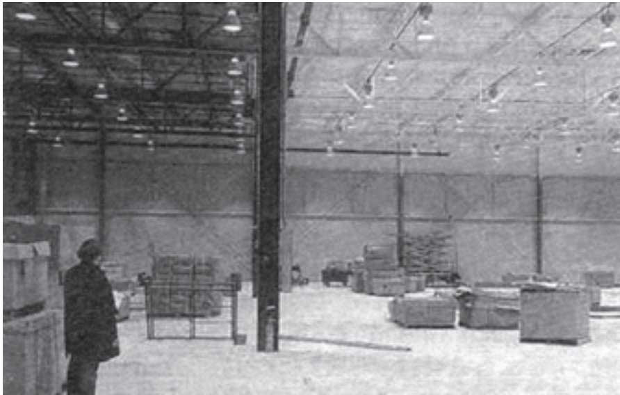
شکل ۲۴-۳- سیستم روشنایی عمومی
