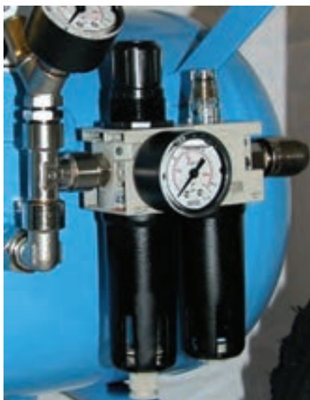
شکل ۱۳-۱- فشارسنج روی مخزن پمپ باد
