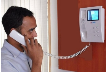
شکل ۸- نصب آیفون بالاتر از حد مجاز
