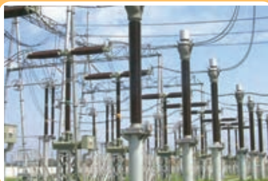
پست تقویت ولتاژ جریان برق
