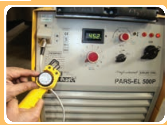
تنظیم آمپر از کنار دست جوشکار توسط سیستم کنترل از راه دور
