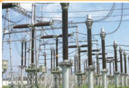
پست تقویت ولتاژ جریان برق
