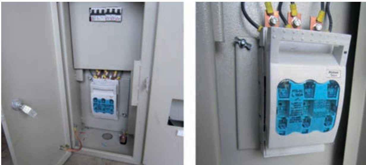
شکل ۲۳-۳- محل ورود کابل اصلی به داخل تابلو
