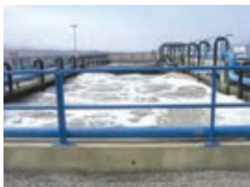
▲ شکل ۸-۲ تصفیه خانه آب
