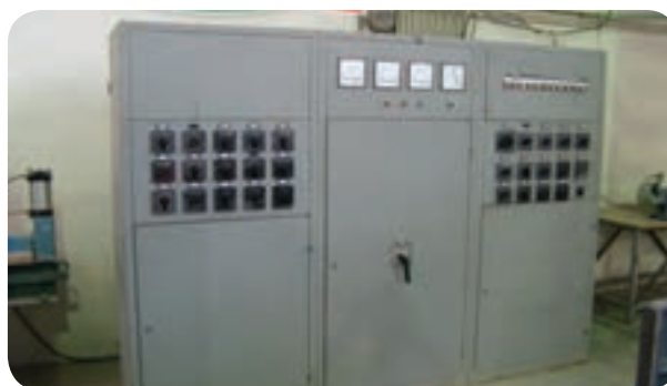
شکل ۸۳-۵: تابلوی اصلی سه فاز برق کارگاه
