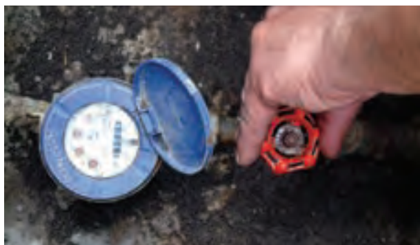
شکل ۱۹۷-۲- بستن شیرفلکه‌ی اصلی
