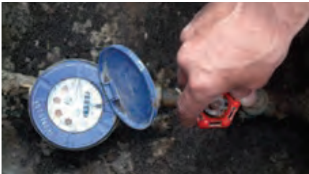
شکل ۱۸۱-۲- بستن شیرفلکه‌ی اصلی
