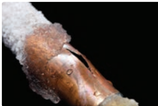
شکل ۶-۵- شکستن لوله آب در اثر انجماد آب
