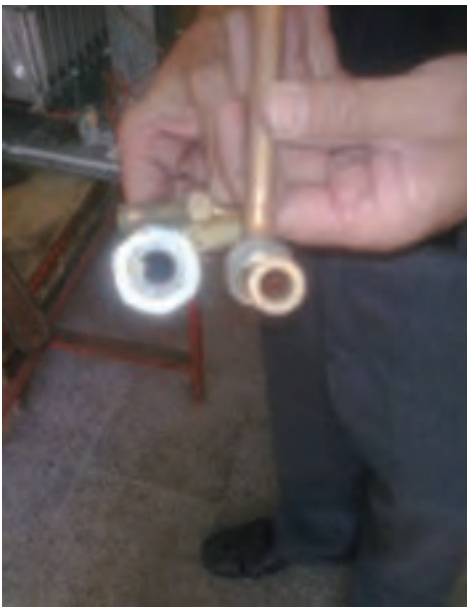
شکل ۱۲-۵- تشکیل رسوب در لوله آب‌گرم
