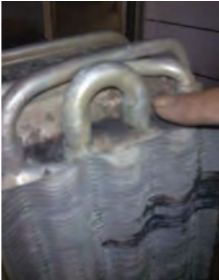
شکل ۱۱-۵- تشکیل رسوب در آب‌گرم‌کن
