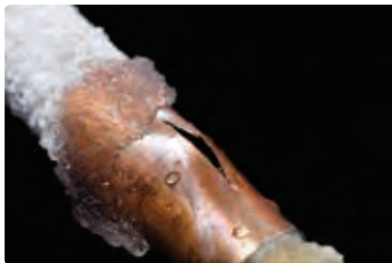
شکل ۶-۵- شکستن لوله آب در اثر انجماد آب
