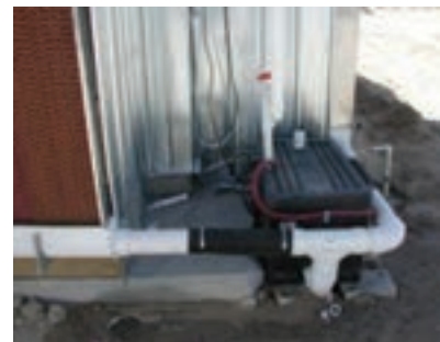
تصویر ۱۲-۲- پمپ و لوله های توزیع آب
