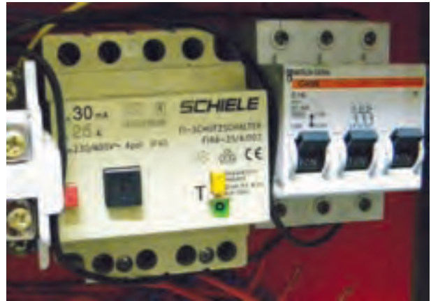
شکل ۲۱-۱- فیوز حفاظتی نصب شده در کارگاه
