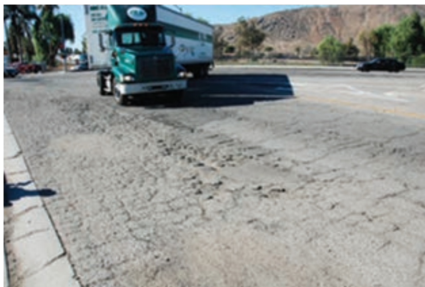
شکل ۱۲-۴- نمونه‌هایی از خرابی‌های روسازی ناشی از ترمز یا وزن زیاد وسایل نقلیه سنگین
