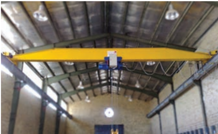
شکل ۲-۳-ب-نمایی از جرثقیل سقفی (تک پل)
