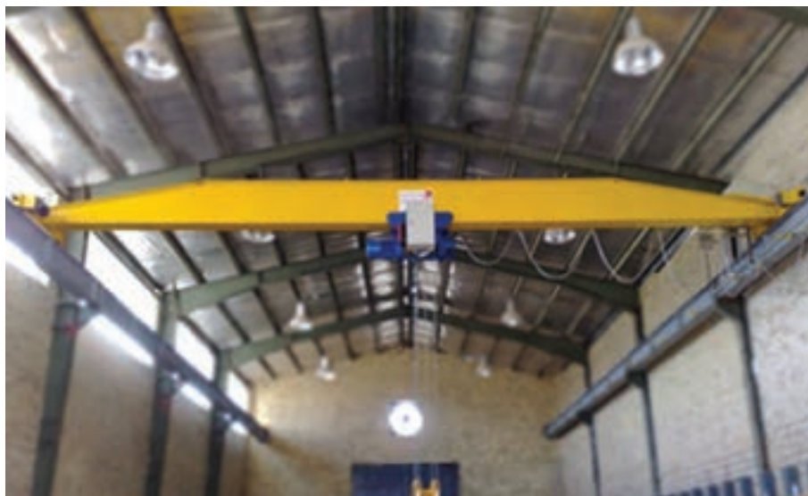
شکل ۲-۳-ب-نمایی از جرثقیل سقفی (تک پل)
