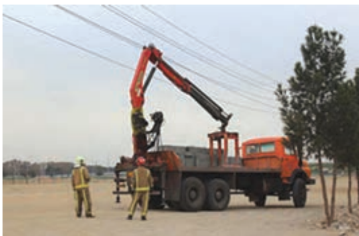
شکل ۴-۵- برخورد جرثقیل با کابل برق
