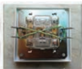
شکل ۲-۸۰ - ساختمان داخلی کلید کولر
