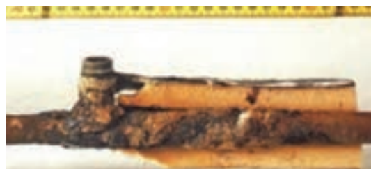
خوردگی موضعی لوله فولادی در زیر عایق حرارتی (پشم شیشه)
