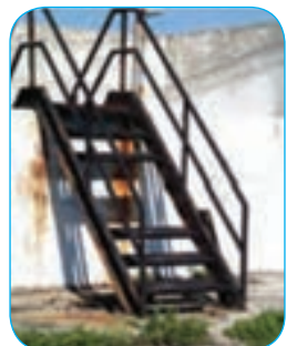
نردبان فلزی در شرایط حیاط خانه دچار خوردگی شده است.
