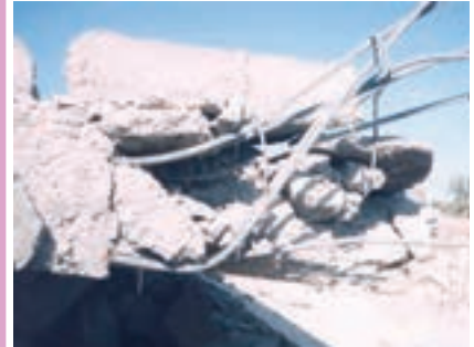
بتن ریزی نامناسب در محل اتصال موجب شده تا آرماتور به حد جاری شدن نرسد و بتن جدا گردد.
