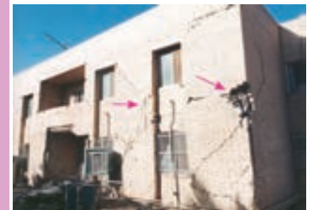
ایجاد ترک‌های قطری در اثر ضعیف بودن شناساز قائم
