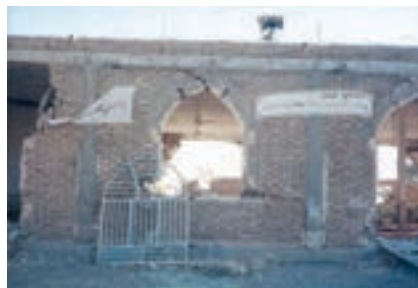
فاصله‌ی زیاد شنازهای قائم و فقدان پیوستگی دیوار به شناز قائم موجب تخریب دیوار شده است.
