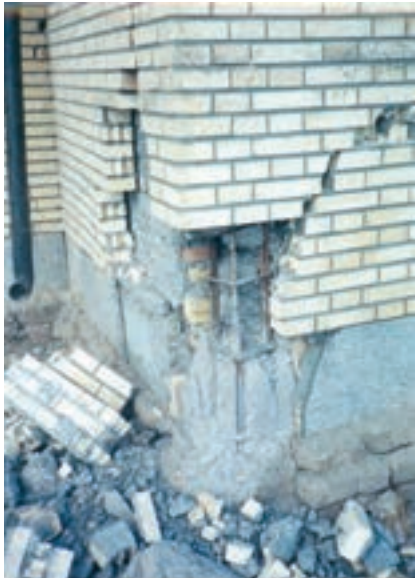
ریزش نمای ساختمان در اثر ناپیوستگی با دیوار و بتن ریزی نامناسب
