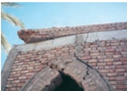
کیفیت نامرغوب بتن و فاصله‌ی زیاد شننازهای قائم موجب ایجاد خسارت در این سازه شده است.
