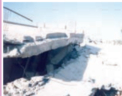
شکست ستون از محل درز اجرایی
