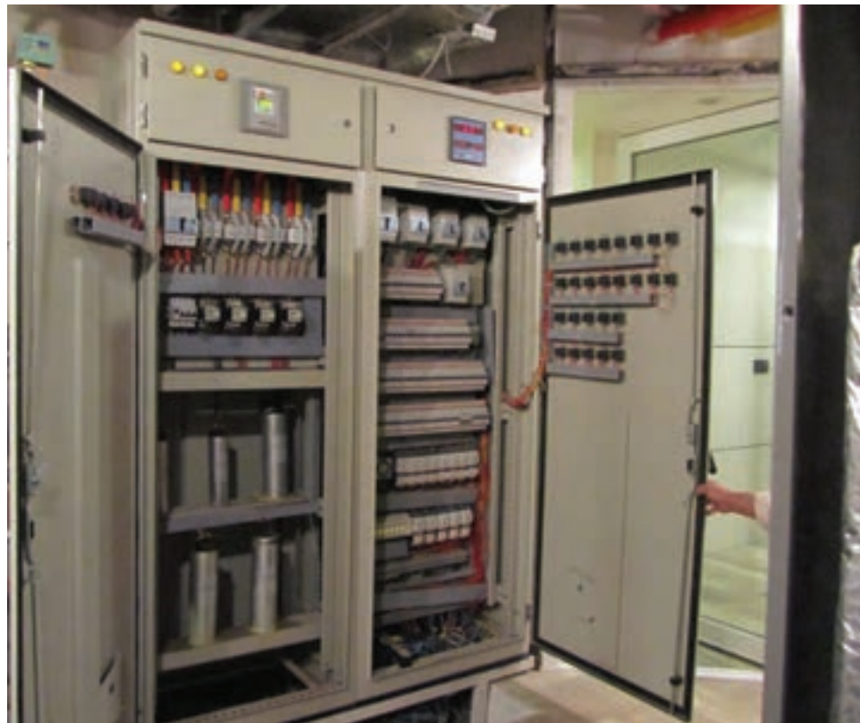
ب) باز شده تابلو برق
