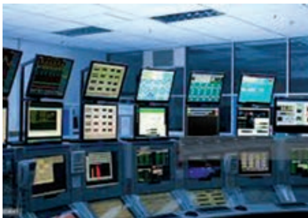
شکل ۲۸- نمایی از اتاق فرمان واحد
