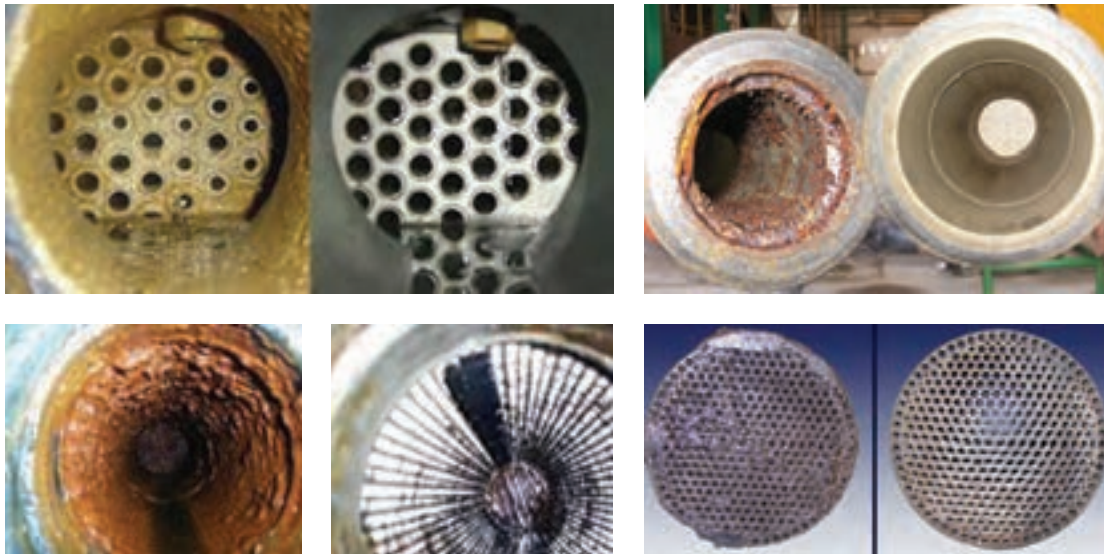
شکل ۲۱- برخی از تجهیزات قبل و بعد از شستشوی شیمیایی
