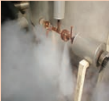
نشتی از اتصال در خط لوله
