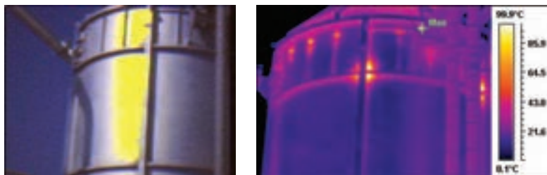
شکل ۲۷- تشخیص نشتی حرارتی از عایق مخازن
