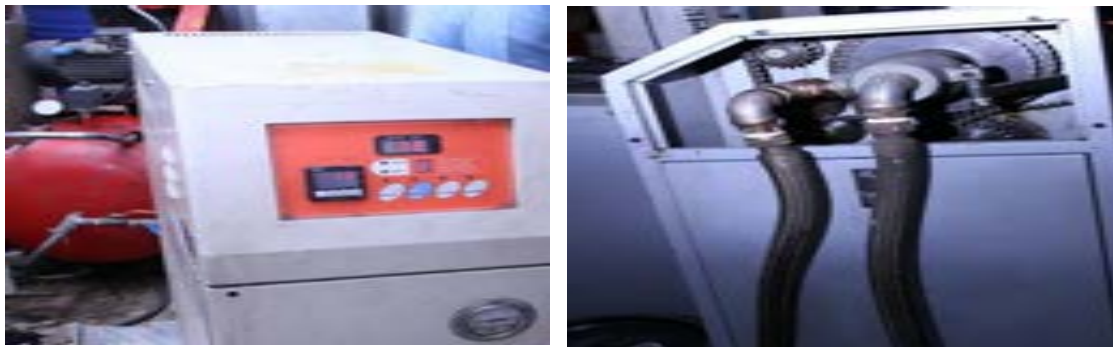
شکل ۲۷- سیستم گرمایشی سیلندر فشار
