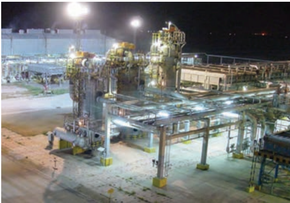
شکل ۳۲-۵- کارخانه گاز و گاز مایع شماره ۹۰۰- اهواز
