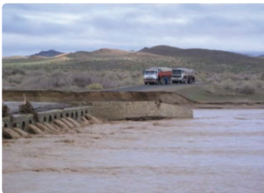
شکل ۴۳-۱- خسارت‌های ناشی از وقوع سیل در شهرستان شاهرود
