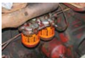
شکل ۵-۶۰- نشست گازوئیل از فیلتر
