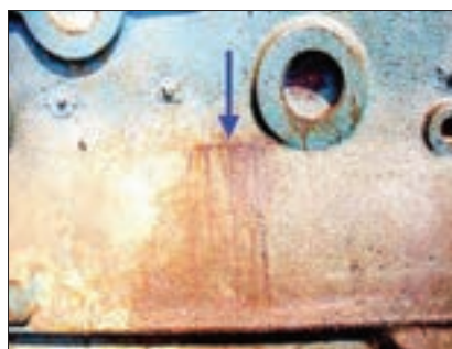
شکل ۴۴- ۲- ترکیدن بلوک سیلندر در اثر سرما
