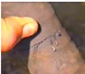
شکل ۶. نشتی از شیلنگ‌ها
