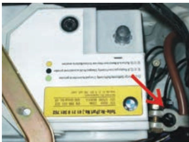
شکل ۲-۱۰۹- باز کردن اتصال منفی باتری
