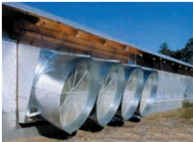
نمای هواکشها از بیرون جایگاه
