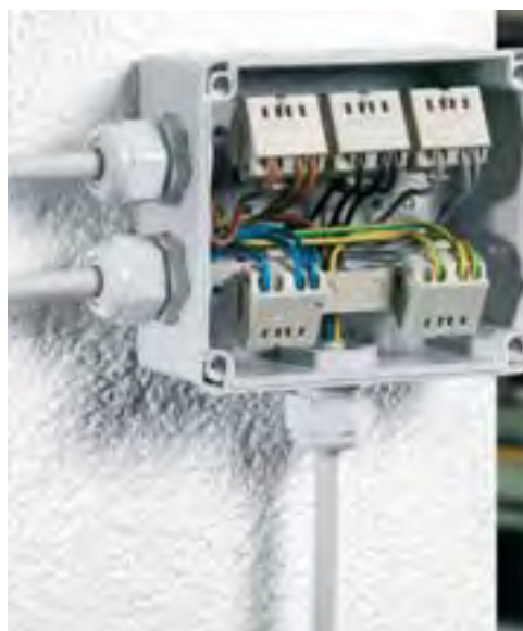
ب) گلند در محل ورود تابلوی برق
