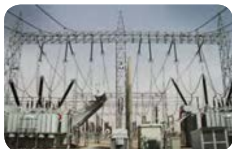
شکل ۱۶- پست انتقال برق
