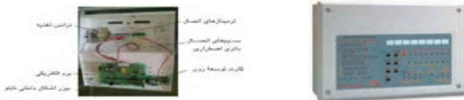
شکل ۱۷- اجزای داخلی تابلوی اصلی
