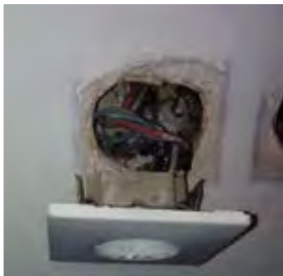
شکل ۵-۳- قاب جداشده پریز از دیوار
