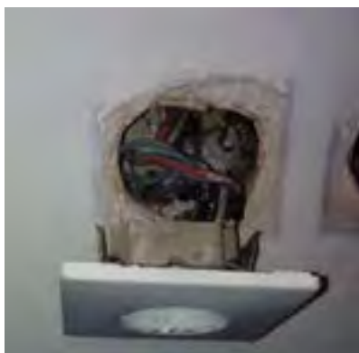
شکل ۵-۳- قاب جداشده پریز از دیوار
