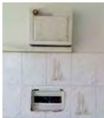
شکل ۵-۲- نصب تابلو فیوز روکار با نوع آسیب دیده توکار
