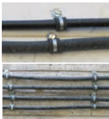
شکل ۲۵- کابل‌کشی روی دیوار
