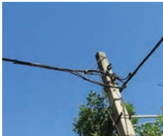
شکل ۲- کابل خود نگهدار
