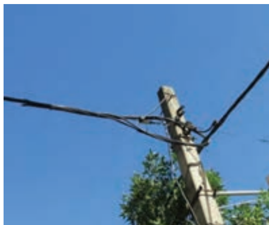
شکل ۲- کابل خود نگهدار
