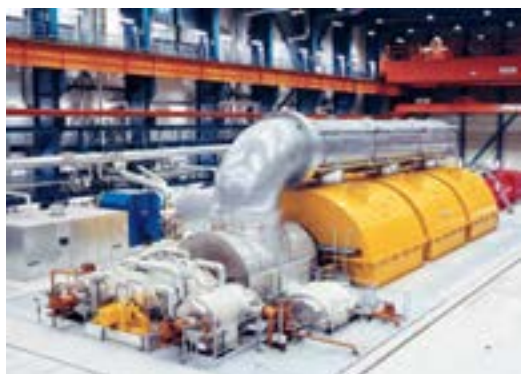
شکل ۲- ژنراتور سه فاز در نیروگاه
