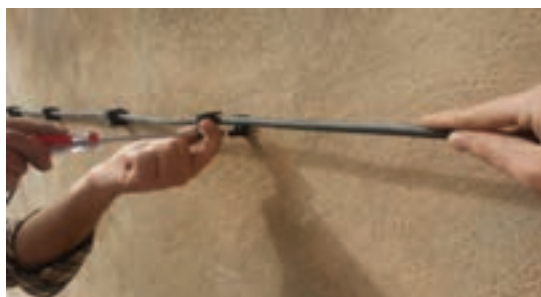
شکل ۳۷- کابل نصب شده روی دیوار
