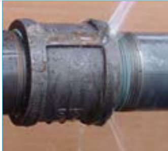
شکل ۱۱-۵ یک اتصال در حال نشتی
