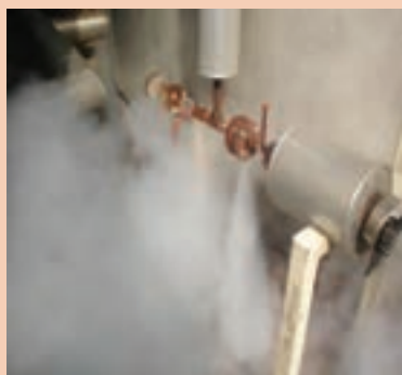
نشستی از اتصال در خط لوله
