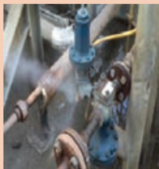
نشستی از خطوط لوله
