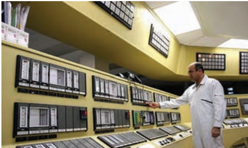
شکل ۳۴- اتاق فرمان موجود در پالایشگاه گاز
